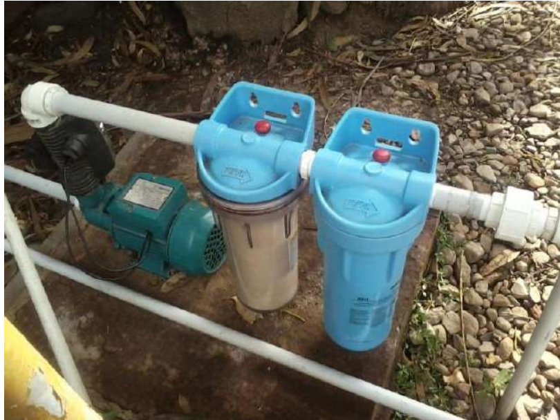
Figura 2 - Bomba de ½ hp provista de presostato de señal eléctrica y filtros comerciales.
