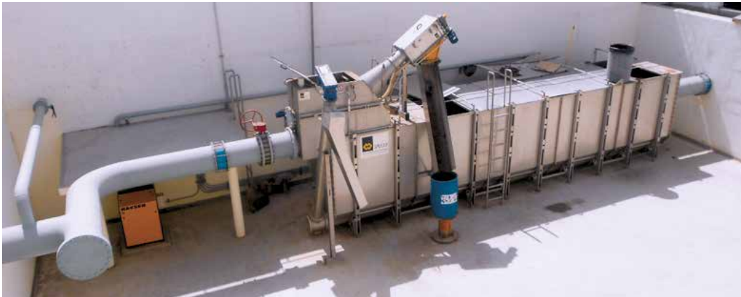
Ilustración 1.2 Rejillas automáticas de limpieza mecánica
