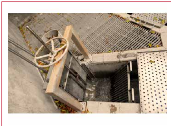
Ilustración 1.1 Rejilla de limpieza manual
